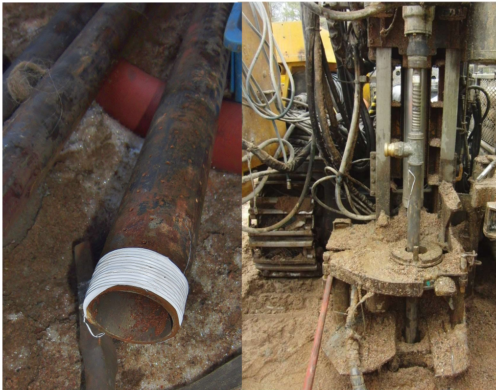
Kuva 10a. Siiviläputki, jonka reikien halkaisija on 2,5 mm. Putken liitäntäpäähän ympärille on kieputettu tiivistenauhaa. 10b. Kairauskalusto ajettuna maahan pumppausta varten. Ylimpään maaputkeen kiinnitettyyn pumppausuuttimeen kytketään pumppuun johtava vesiletku.
