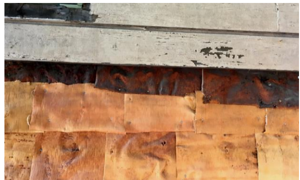
Kuva 4: Vanhoja suurista tuohilevyistä tehtyjä eristeitä näkyy empiretalon julkisivulla Kaskenkadun varressa, kivijalan yläpuolella. Kuvaaja: Terhi Arell 2019.
