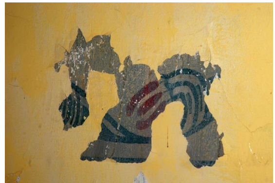
Kuva 4: Porraskäytävän rapistunut koristehevonen Kuvaaja: Terhi Arell 2018.
