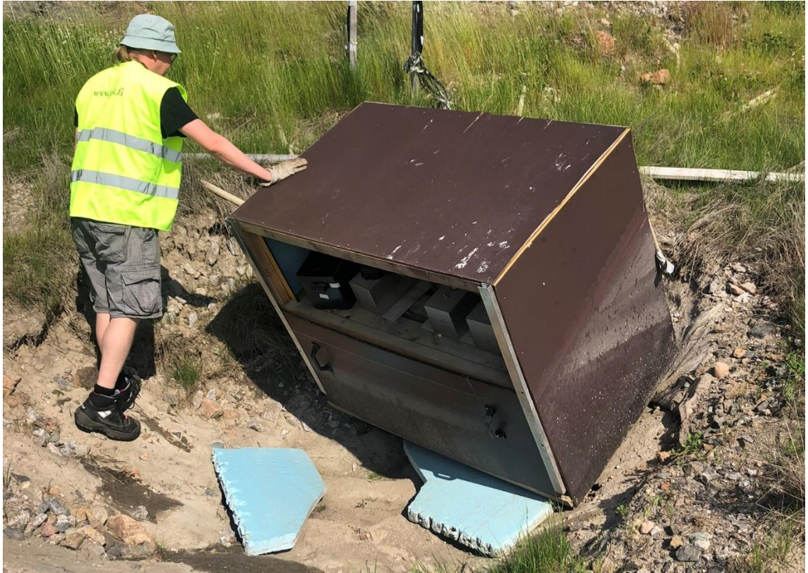
Kuva 8. Kevättulvan aiheuttama maanvyörymä on siirtänyt ja lähes kaatanut Hituran koejärjestelyn suotoveden keräyspisteen.
