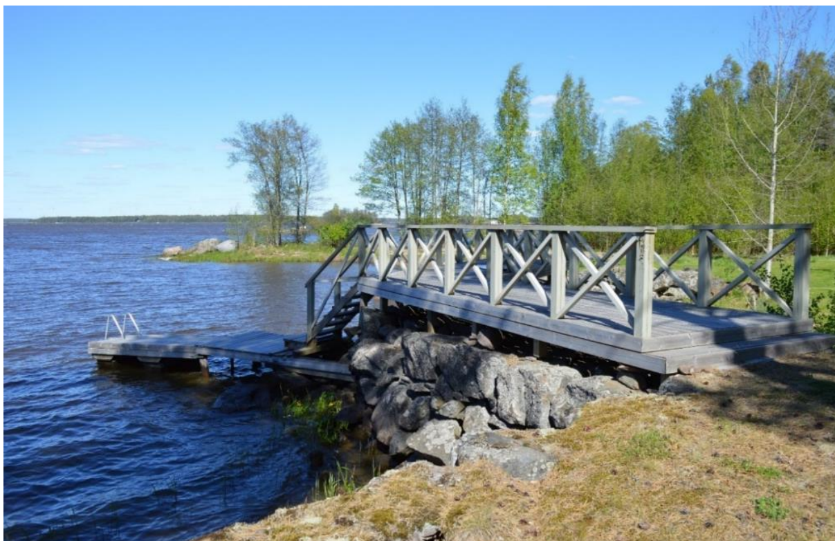
Kuva 5. Huvilan laituri on lyhennetty versio aiemmasta luonnonkiviarkun päälle rakennetusta, jossa oli uimahuone. Laituriin on maankohoamisen vuoksi tehty korkeuseroa tasoittamaan ponttoonilaituri. Toukokuussa 2020 otetussa kuvassa vedenrajassa kukkivat keltaisena rentukat. Valokuva Anne Salonen.
