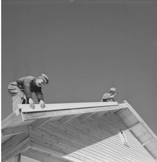
Kuva 2 Elementtitalon rakennustyömaa Varkauden Könönpellossa vuonna 1946. Kuvassa kohoaa ilmeisesti A-talo. Kuva: VM/Valokuvaamo Jäniksen kokoelma, Pauli Jänis.
