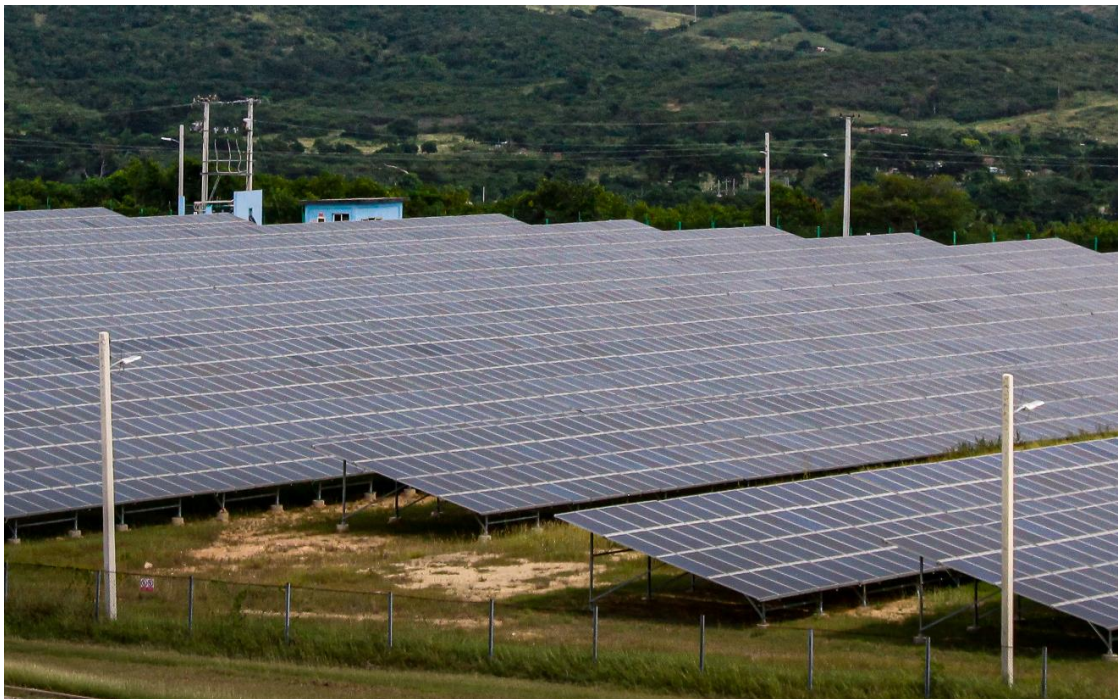
Parque Solar Fotovoltaico, Abel Santamaría, Santiago de Cuba
