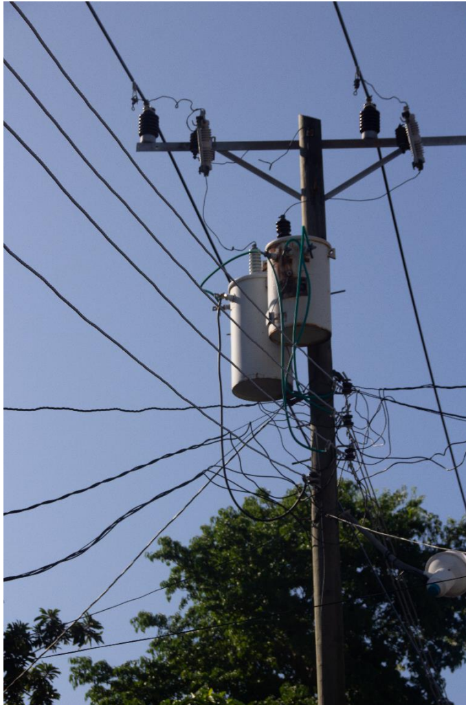
Transformador de red de distribución
