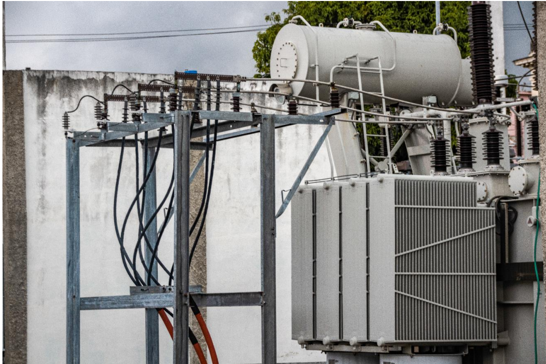
Transformador, La Habana
