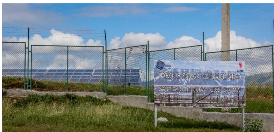
Parque solar fotovoltaico, Abel Santamaría, Santiago de Cuba
