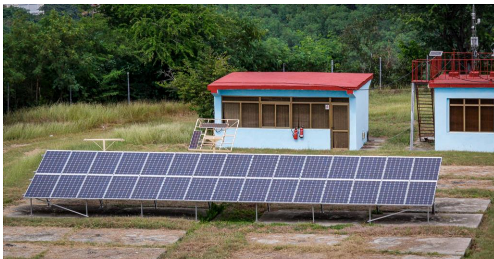
Parque Solar Fotovoltaico, Abel Santamaría, Santiago de Cuba
