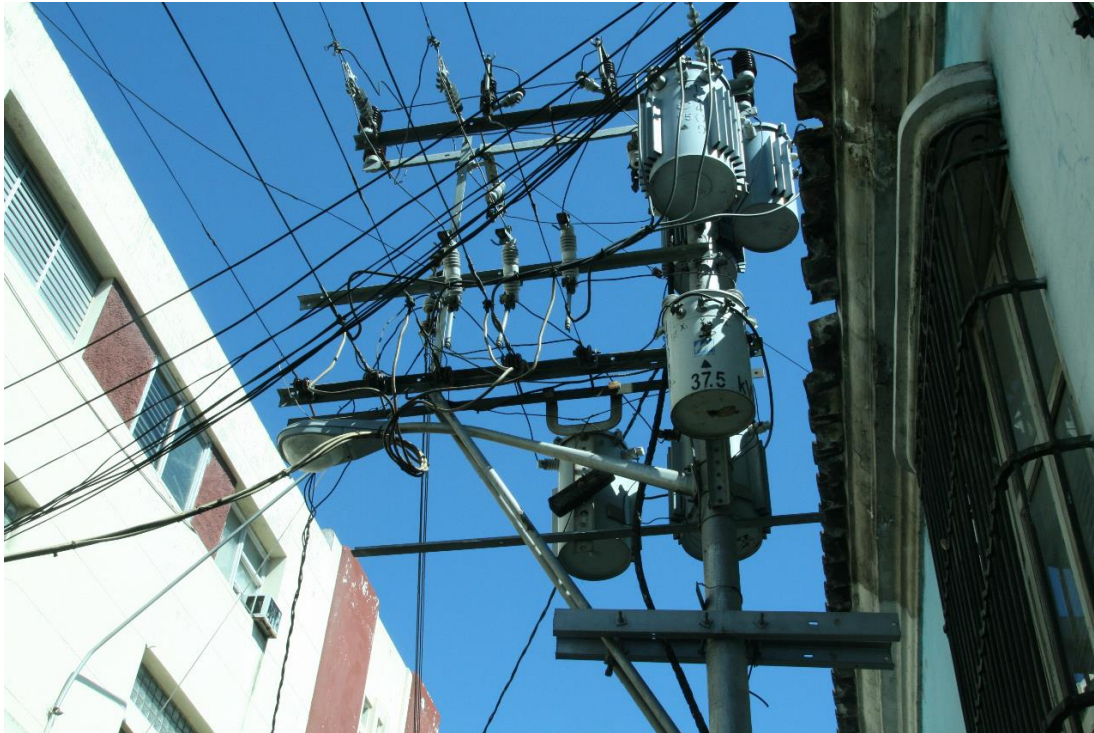
Transformadores de red de distribución, Santiago de Cuba
