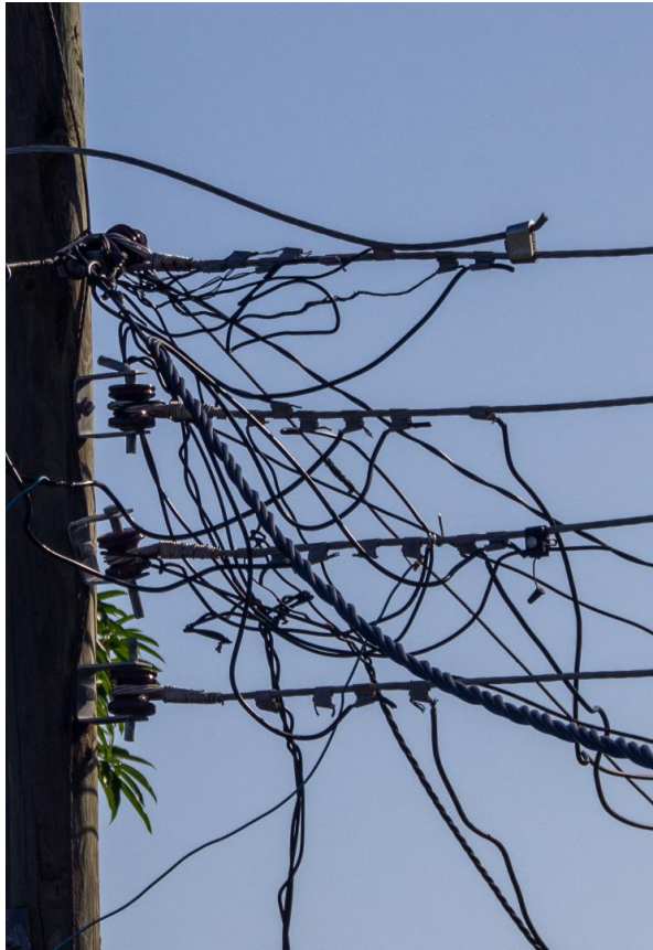
Instalaciones de redes de distribución, La Habana
