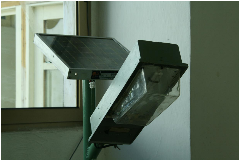
Luces del alumbrado público, alimentadas con paneles fotovoltaicos
