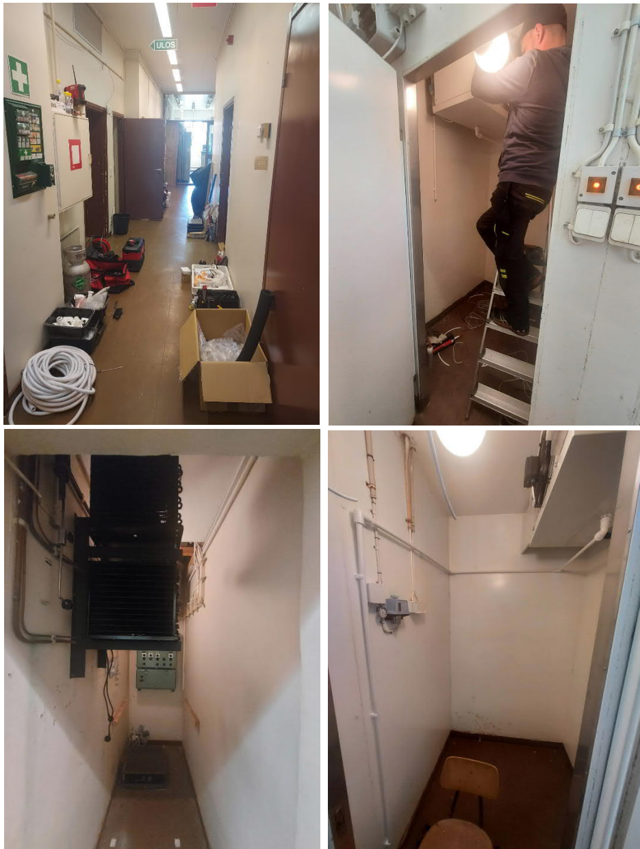
Kuva 4. Lähtötilanne- ja asennuskuvia päivitystyön kohteina olleille entiselle kylmähuoneelle ja niiden koneistoille saneeraustöitä aloitettaessa kesällä 2021.
