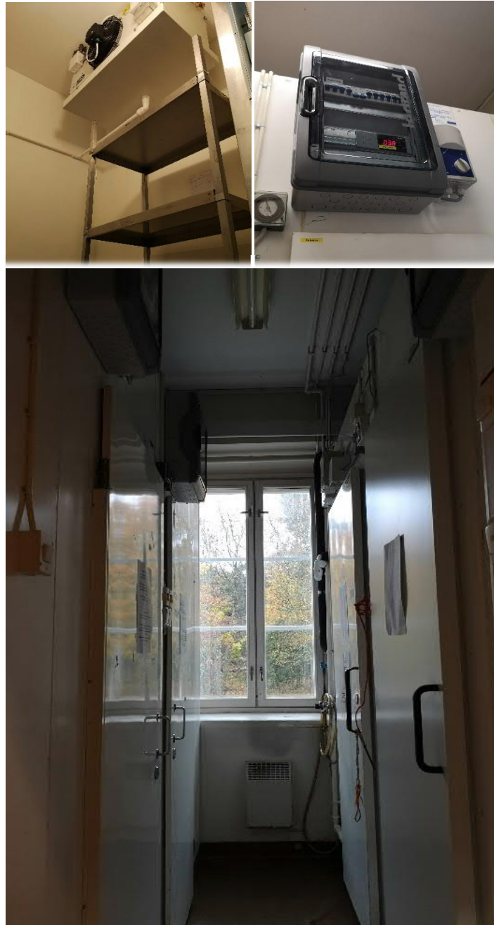
Kuva 5. Kylmähuoneiden uusi höyrystin (ylävasen), ohjainyksikkö (yläoikea) sekä näkymä valmiista lopputulemasta (kylmiöt vasemmalla, pakastin oikealla) saneeraustöiden päättyessä syksyllä 2021.
