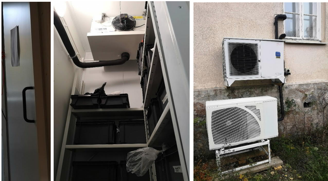
Kuva 6. Uuden pakkashuoneen karmilämmitteinen ovi (vasen kuva), osin jo varustellun pakkashuoneen sisänäkymä, jonka yläosassa uusi AlfaLaval:in puhallinhöyrystinyksikkö (keskellä) sekä rakennuksen ulkopuolelle sijoitettu talvivarusteltu pakastinkompressorikoneisto (oikealla) saneeraustöiden päättyessä syksyllä 2021.
