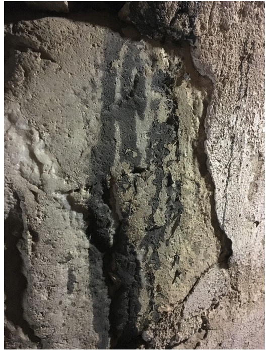
Kuva 9. Runkokuoneen eteläseinässä asehuoneen ullakolla on nähtävissä runkokuoneen eteläseinän rappauksen puuttuminen asehuoneen päätyseinien yläpuolisilta, asehuoneen katon alle jääviltä osin. Kuva: Livady.
