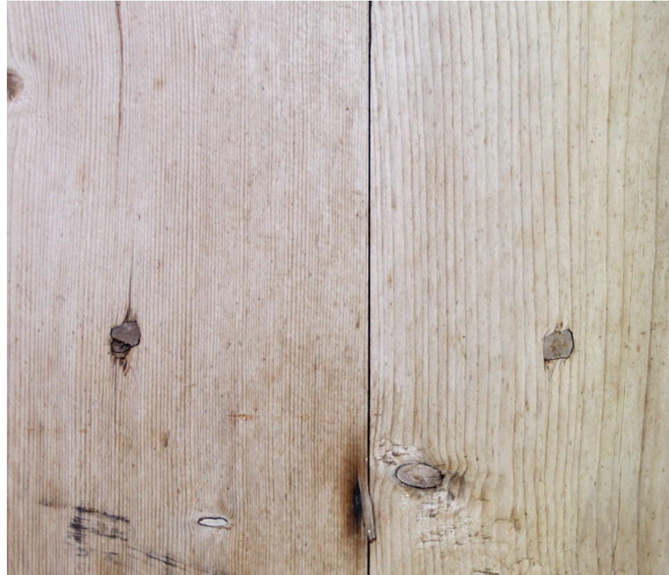
Laipiolaudoituksen listarakenteen liitoksen pieniä puunauloja.
