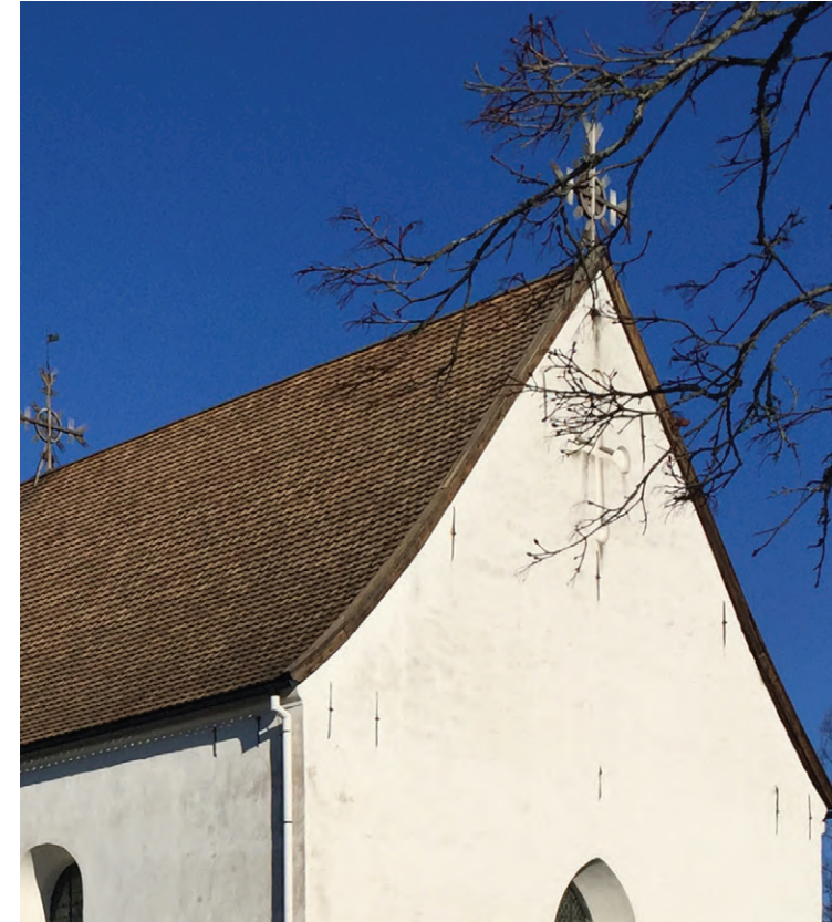
Alapaarteet on sidottu tiilimuriin julkisivussa näkyvin ankkuriraudoin. Myös uloimman kattotuolin ankkuriraudat näkyvät päätymuurissa.
