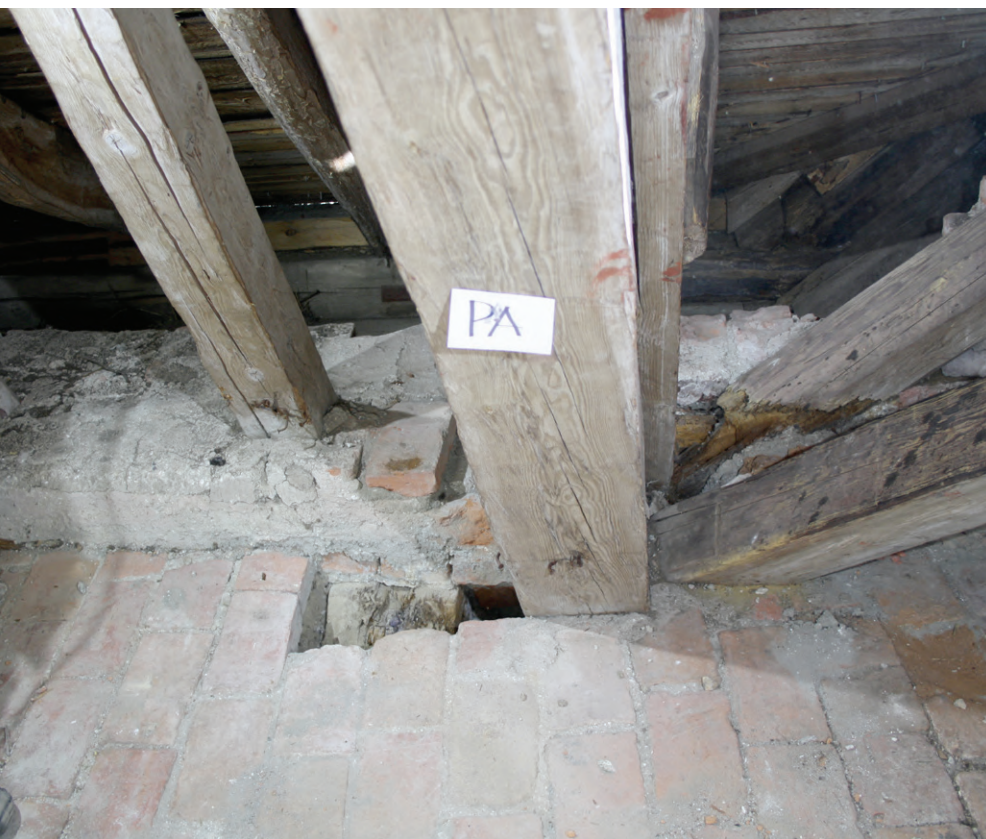
Kuva päätypukista PA ennen rakenteen avausta. Pukin jalan kohdalla oli vanha vesivaurio jonka takia puuosat sekä tiilimuuraus olivat vaurioituneet.
