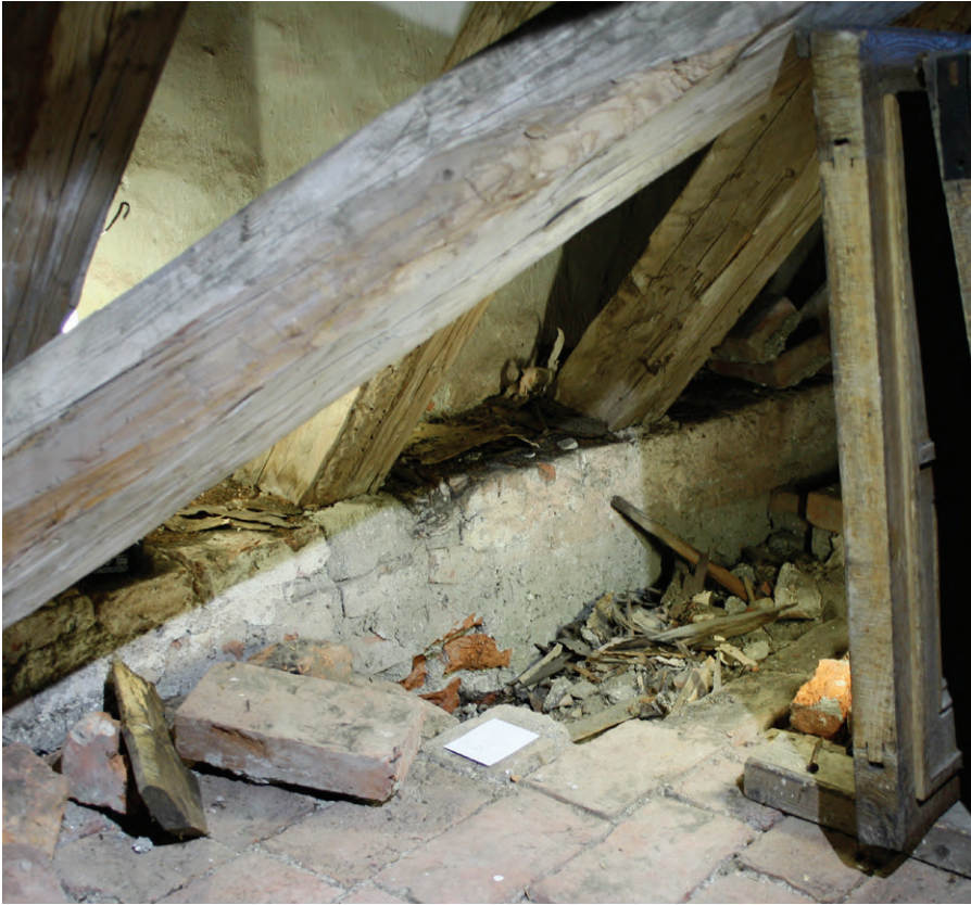
Lounasjulkisivun tutkimuskohta oli jo valmiiksi vaurioituneessa kohdassa.
