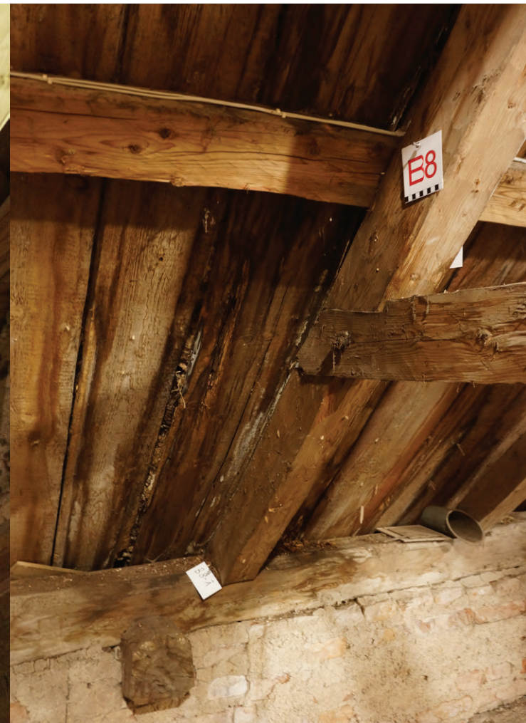
Puutarhan puoleisen kaakkoislappeen lahovaurio ulottuu alempaan lautakerrokseen asti.
