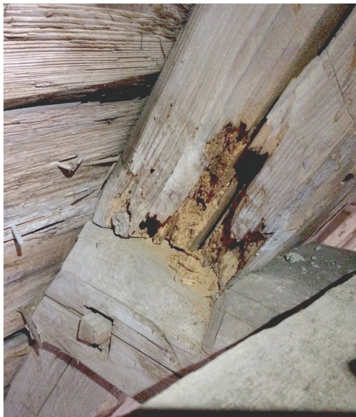
Koko kattorakenteen ainut yläosan lahovaurio koillisen puolen selkäpuun ja ylimmän kitapuun (a) liitoksessa.
