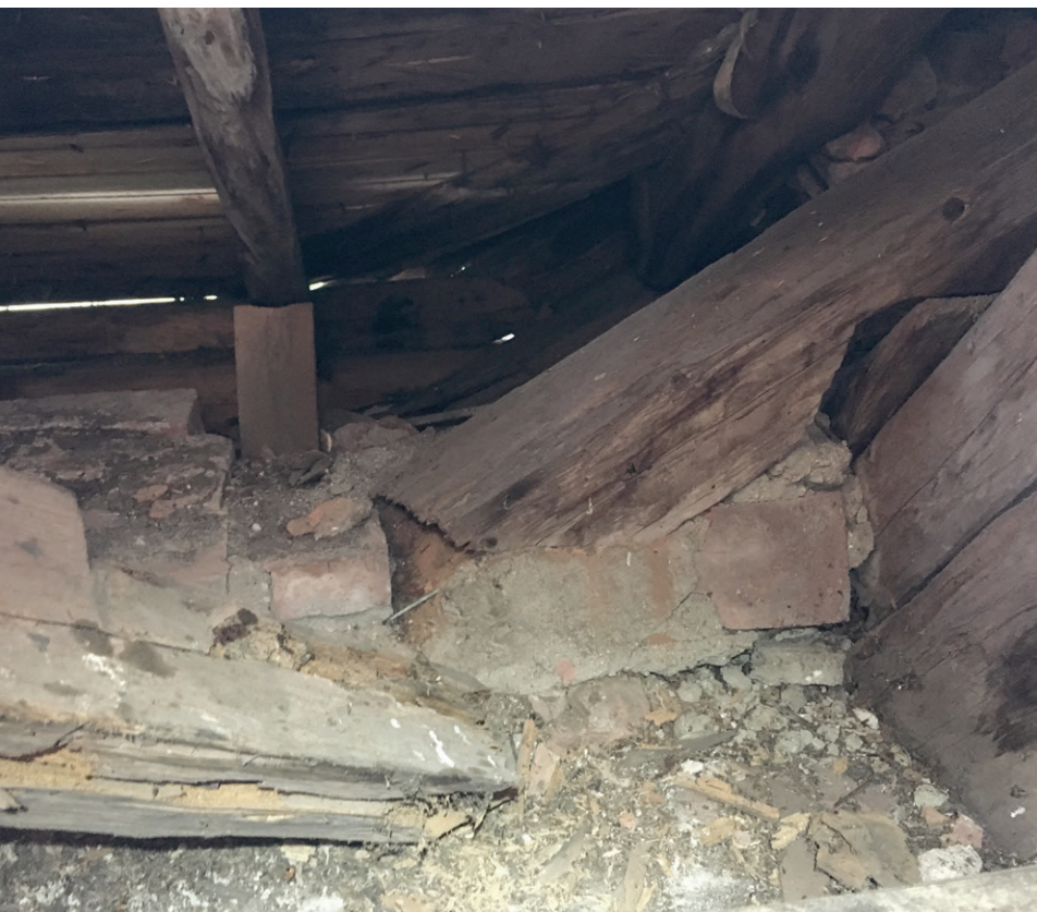
Pukkeja yhdistävä saksipuu on lahovaurioitunut viereisestä kattolyhdystä vuotaneen veden takia. Lounaissivulla on kolme lahovaurioitunutta saksipuuta.
