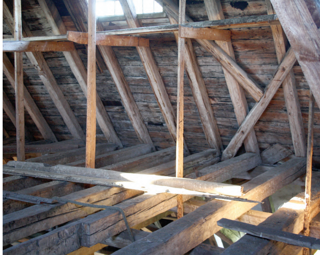
Kattolyhtyjen rakennustelineet on jätetty paikoilleen. Selkäpuita ei ole katkaistu kattolyhtyjen kohdalta. Kuvassa näkyy myös vinotukia, joilla kattorakennetta on jäykistetty.
