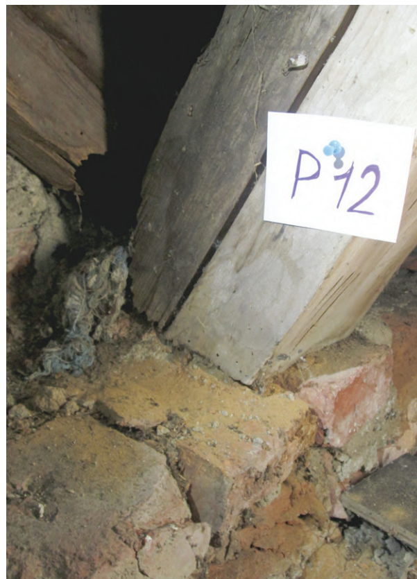
Selkäpuun lahovaurio. Myös takana näkyvä keskiakselin päätykolmioon liittyvä puuosa on alapäästään lahonnut.
