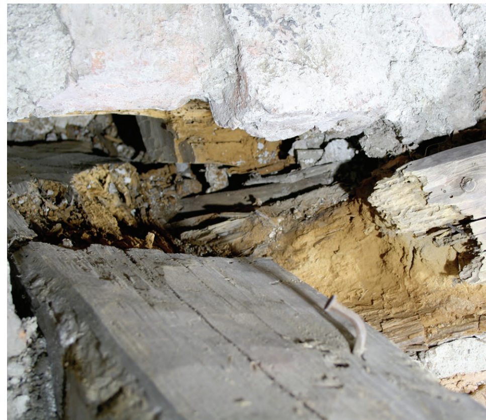
Kuvassa oikealla näkyy muurin sisäisestä liitoskohdastaan täysin lahonnut saksipuu ja kattotuolin selkäpuu. Myös muurin sisällä olevassa kehäpuussa oli selkäpuun kohdalla lahovauriota.
