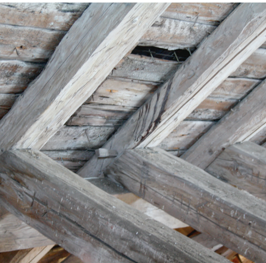
Kattotuolin selkämpuiden ja alimpien kitapuiden liitoksia. Osa tapeista on katkaistu, osa ei.
