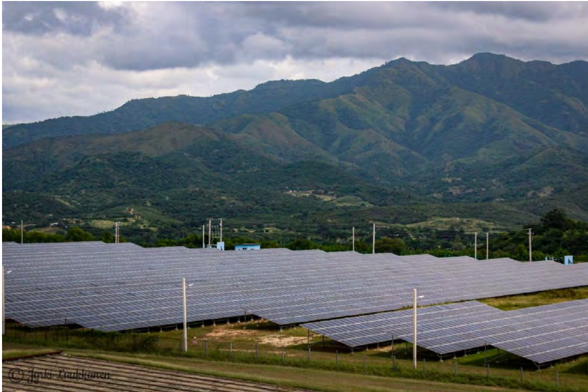
The solar power plant, Abel Santamaría, Santiago de Cuba
