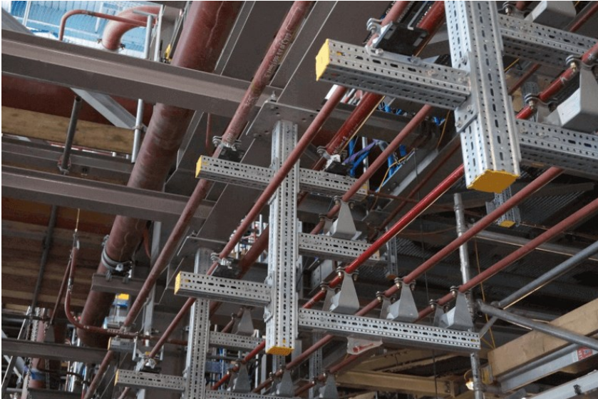
Kuva 8. Sikla SiFramo-järjestelmä asennettuna putkien sekundäärikannakkeeksi (Sikla, n.d.-b).
