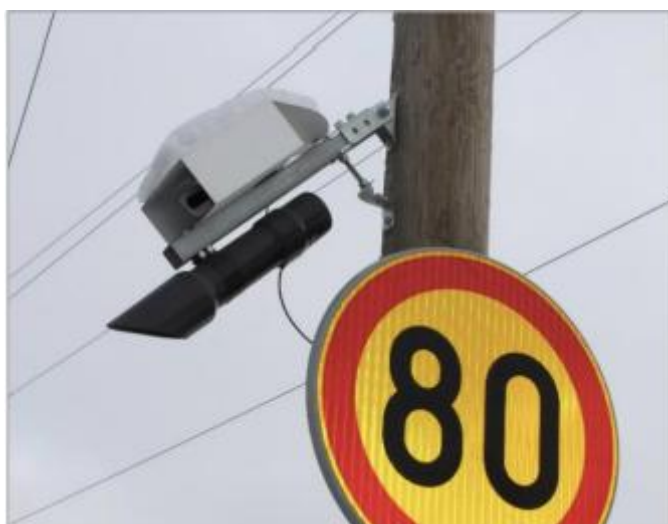
Kuva 8. Tiesääasema RWS10 asennettuna tien varrella olevaan pylvääseen. Kuva lähteestä Teconer Oy, Tekijänoikeudet Teconer Oy 2025 [24].
