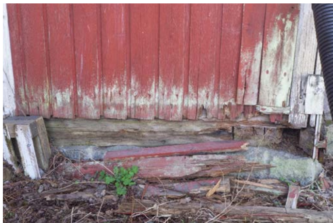
Kuvassa näkyy rakennuksen kuistin lahoaurioita. Rakennus on painunut keskiosastaan kasaan niin, että kuisti kaatuu talon päin. Tämän korjaamiseksi rakennuksen alimpia hirsikertoja on todennäköisesti vaihdettava ainakin talon pohjoispäädyssä, jossa kuisti sijaitsee. Myös itse kuistin alimpia hirsikertoja olisi vaihdettava kuistin säilymistä varten. Kuva: Jenny Lehto. HKTL-arkisto, Turun yliopisto.
