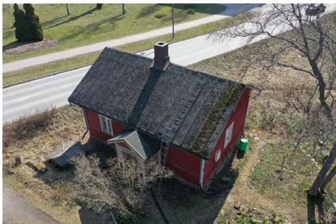
Kuvassa näkyy rakennuksen bitumikaton kunto. Katon samaloituminen heikentää todennäköisesti sen kuntoa, ja katto olisi syytä uusita rakennuksen säilymistä varten. Kuva: Juha Ruohonen. HKTL-arkisto, Turun yliopisto.
