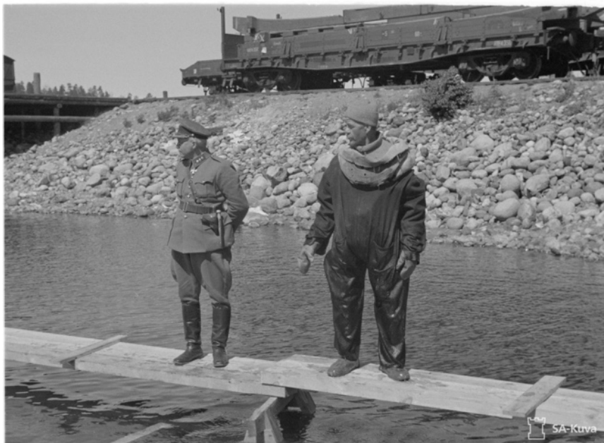
Kuva 3 Eversti Järvinen ja sukeltaja Punkasalmen liukuratatyömaalla. Sukeltajia käytettiin rakentamaan kiskot, joita pitkin aluksia saatiin nostettua vedestä ja sitten kuljetettua kohti Laatokkaa. Kuvan lähde: SA-kuva, kuvan numero 93117. Kuvaaja: C.G. Rosenqvist.
